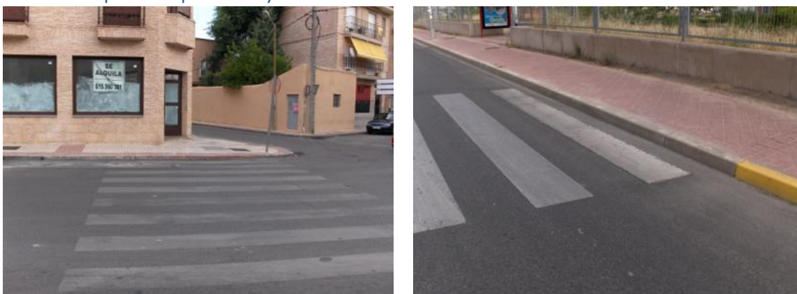
Ilustración 48.- Problemas accesibilidad por falta rebajes en bordillos de pasos de peatones: paradas 33 y 99
